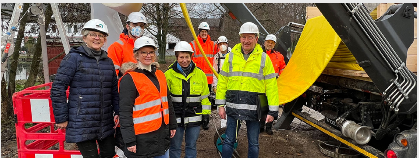
Emissionsarmes Verfahren zur Instandsetzung von Asbestzementrohren: Gleich zwei Baustellen hat der RSV vor Weihnachten in der Stadt Heiligenhaus in NRW mit Hilfe des TÜV Nord begleitet. Ziel ist, das vor Ort härtende Schlauchlining als emissionsarmes Verfahren gemäß der Vorschriften zum Arbeitsschutz in Deutschland anerkennen zu lassen. Mit dabei (v.l.): Reinhild Haacker (RSV), Ardion Xhafa (Aarsleff Rohrsanierung), Christina Krüger, (Aarsleff Rohrsanierung), Valentina Hajdukov (Stadt Heiligenhaus), Daniel Korczinski (RSV, Ingenieurbüro ISAS GmbH), Torsten Berlin (Aarsleff Rohrsanierung), Matthias Borkenfeld (Tuttahs und Meyer Ingenieurgesellschaft), Jürgen Zinnecker (Aarsleff Rohrsanierung).
