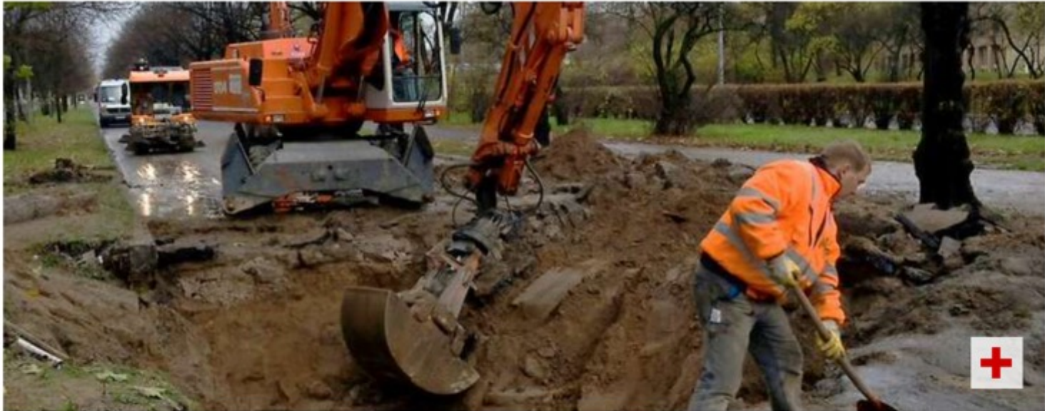
Die geplatze Abwasserdruckleitung unter dem Tempelhofer Damm. FOTO: DAPD
