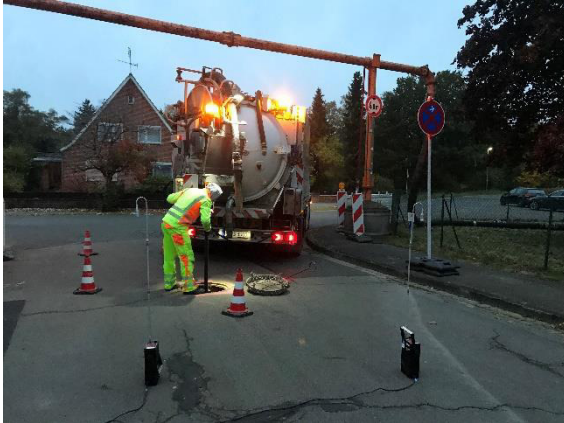
Bild 12: Kanalspülung (Eckhard & Schwarz)
