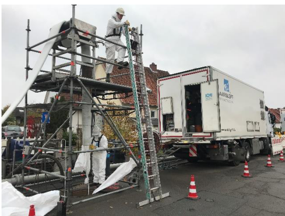
Bild 11: Inversionsturm, Heiztruck (Wasser)
