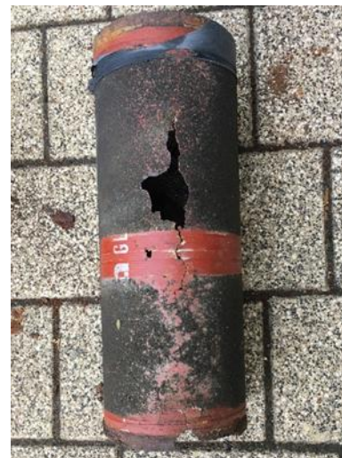
Abbildung 8: Korrosion in Verbindung mit Lochfraß/Materialausbrüchen
