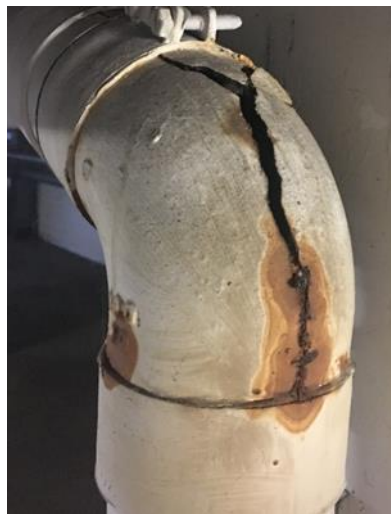
Abbildung 7: Korrosion in Verbindung mit Längsrissen
