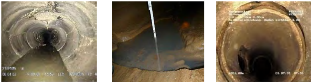
Abbildung 5: Anwendungsbeispiele für das TIP-Verfahren. Links: Deformation (AZ IIIa), Mitte: Ausbruch an der Rohrsohle (AZ III), Rechts: fehlendes Rohrstück (AZ IIIa)
