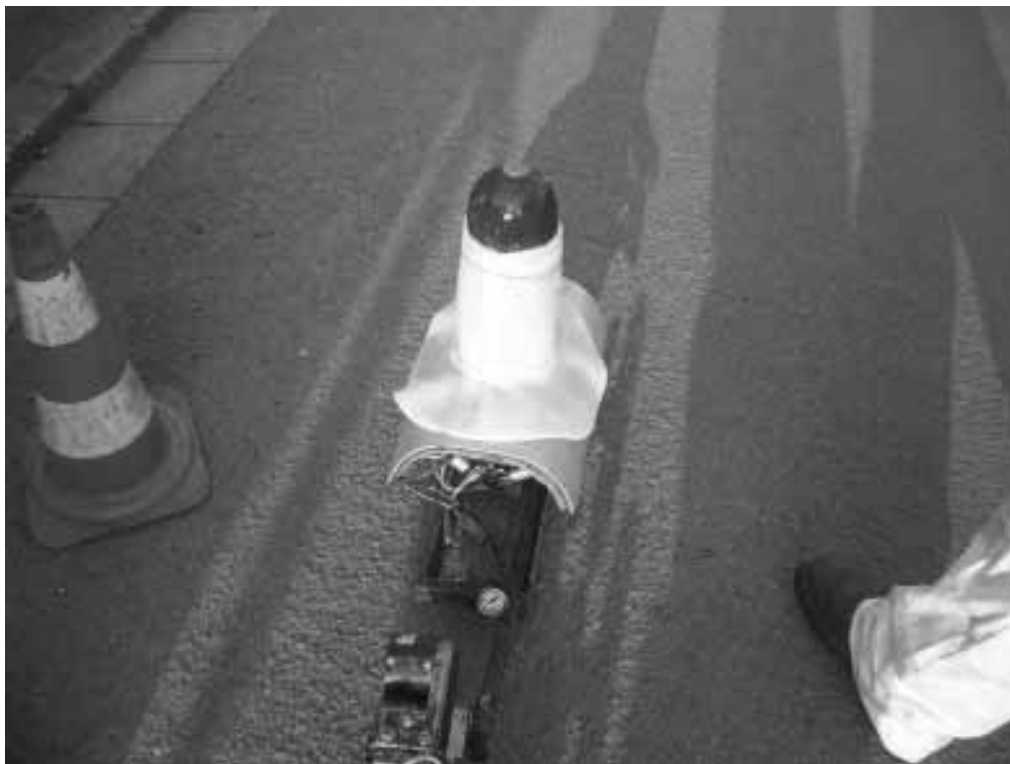
Bild 3: Hutprofilsetzgerät mit festem Schild und angebrachtem, imprägniertem Hutprofil bereit zum Einfahren des Stuzzens vor dem Einsetzen in den Kanal
